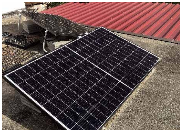
Balkonkraftwerk auf Garagendach
